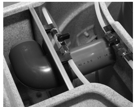
Abbildung 17.3 Bypass in Betrieb
