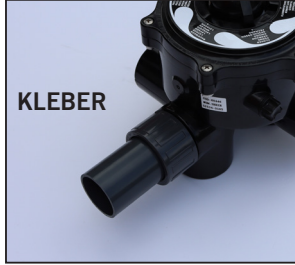
KLEBER Eines der 9 cm Rohre in das Schraubfitting einschieben. DIESE VERBINDUNG WIRD SPÄTER GEKLEBT.
